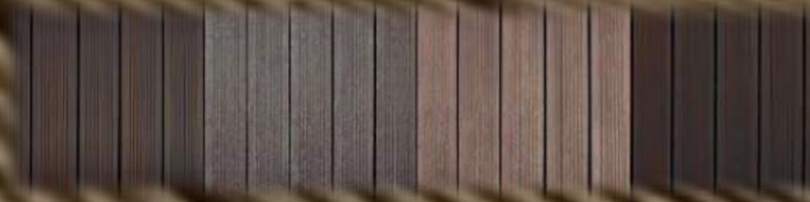
Na installatie Na 6 maanden Na schoonmaken Na onderhoud
